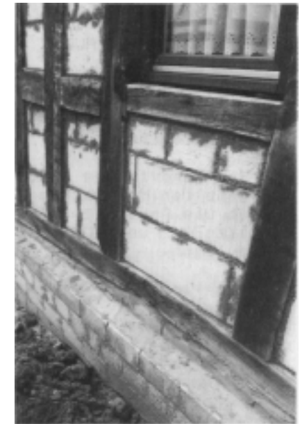
Fachgerechte Renovierung Gasbetonmauerwerk liegt ca. 2 cm hinter dem Fachwerk zurück.
